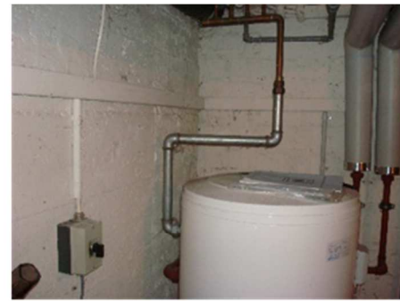
Altbau: Ölkessel mit Boiler. Einsparung durch Weglassen Dämmung CHF 200.00 Mehrverbrauch in 25 Jahren CHF 700.00
